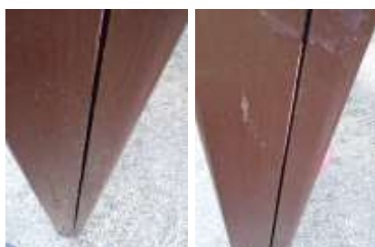
2) Opatřený povrch stojiny, praskliny
