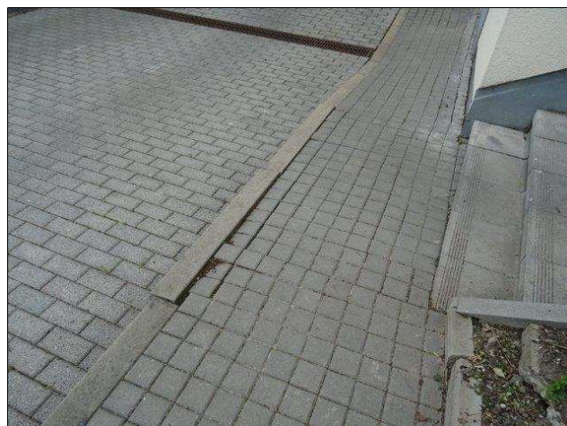
foto /66/ Propadlá dlažba u rampy vedoucí do garáží objektu
