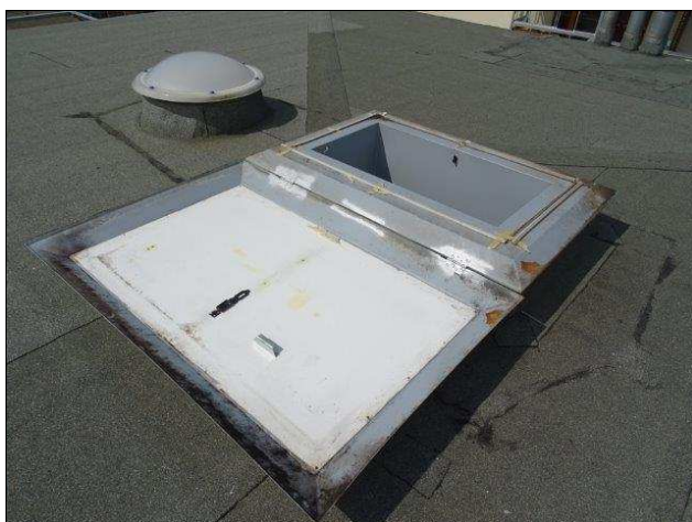
foto /15/ Střešní výlez na objektu A – chybějící omezovač otvírání
