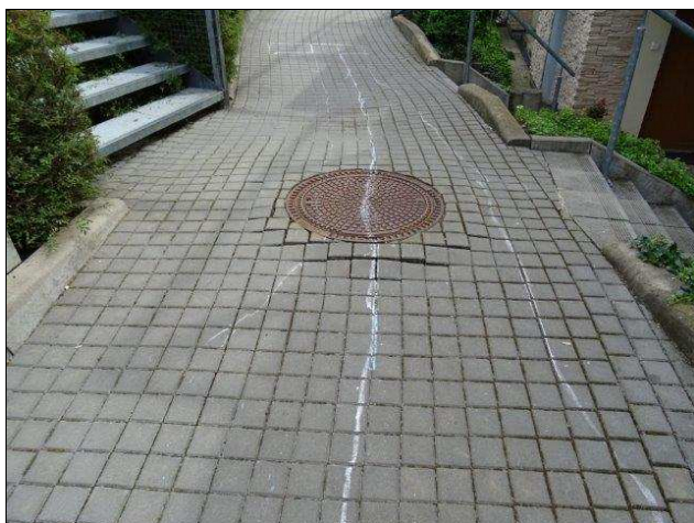
foto /63/ Propadá betonová dlažba na chodníku vnitrobloku
