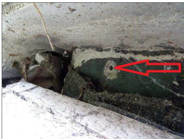
foto /38/ Detail ukončení hydroizolace v místě soklu objektu – utržení asfaltového pásu včetně kotevního prvku
