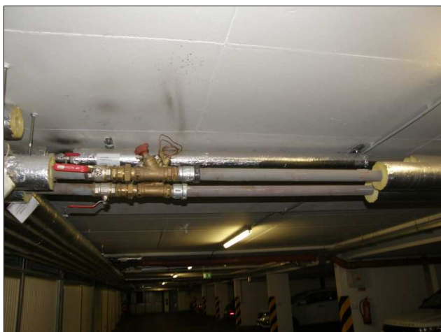
foto /81/ Absence izolace na části potrubí od provádění opravy nebo údržby
