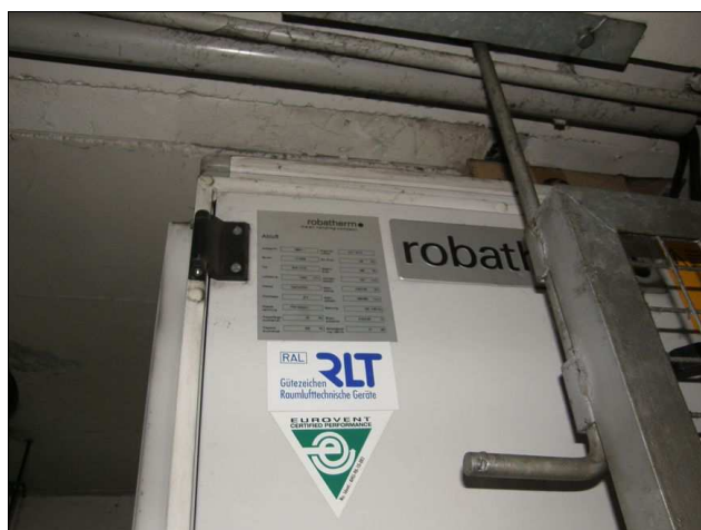
foto /73/ Vzduchotechnické zařízení pro odvod vzduchu z garáží
