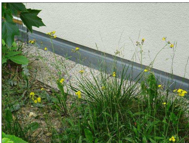
foto /67/ Propadlý okapový chodník kolem objektu
