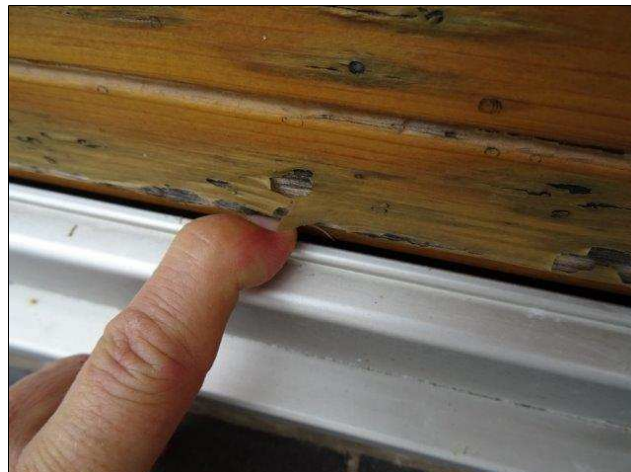
foto /44/ Netěsnosti u funkčních spár výplní otvorů
