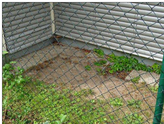
foto /68/ Propadlý okapový chodník kolem objektu
