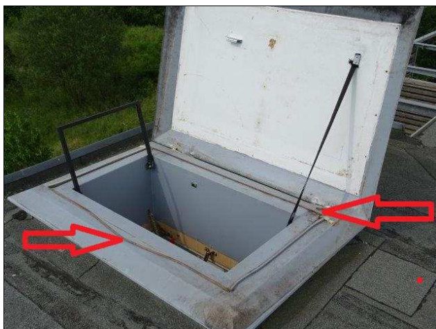
foto /13/ Uvolněné nebo poškozené těsnění u střešního výlezu (objekt C)
