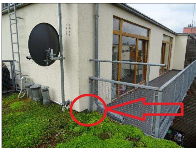
foto /16/ Netěsnost v hydroizolaci na střeše objektu C5
