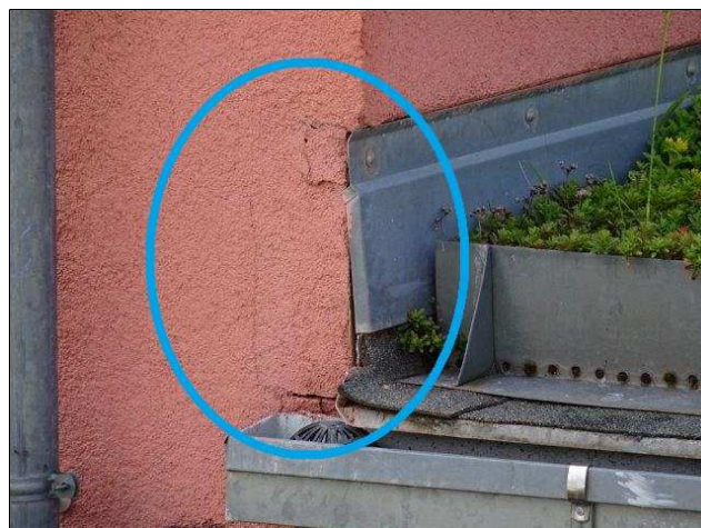
foto /23/ Trhliny v detailu soklu na severní fasádě objektu C6 (4.NP) - detail
