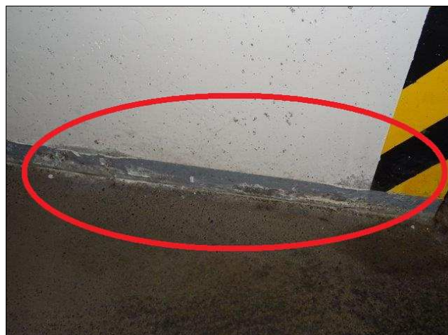
foto /34/ Projevy vlhkostních poruch u paty stěn v 1.PP
