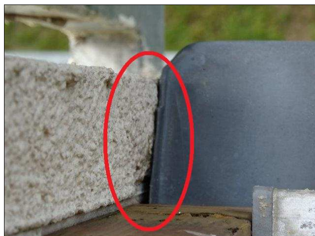
foto /46/ Nesystémové a netěsné ukončení vnějšího parapetu u ostění okna
