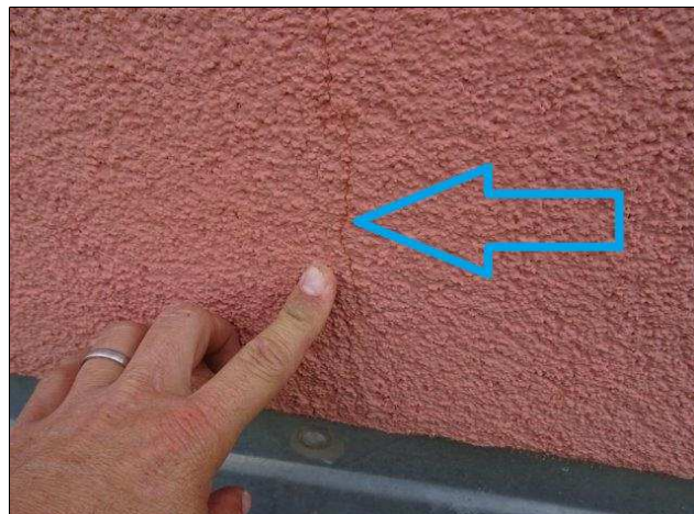
foto /21/ Fasáda 4.NP objektu C6 – trhliny ve fasádě vedoucí svisle od soklu stěny, výskyt po celé délce fasády
