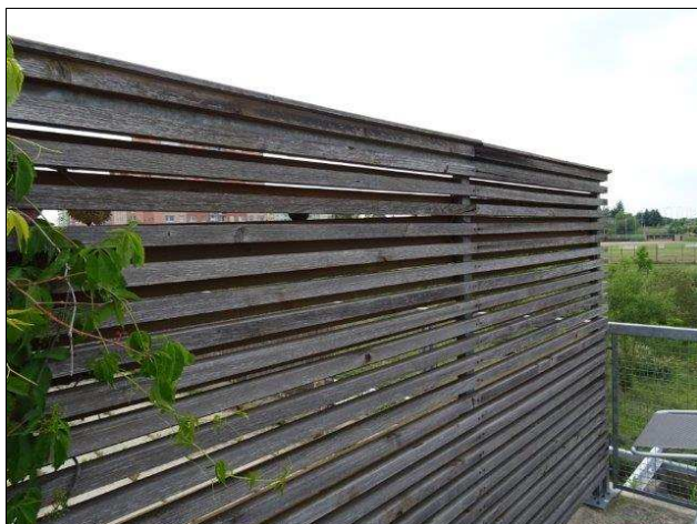
foto /71/ Degradace nátěru dřevěných konstrukcí, lokální praskliny a zkroucení dřevěných prvků
