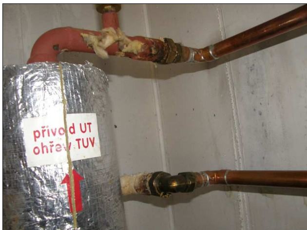
foto /79/ Na rozvodech TV v kotelně chybí tepelná izolace, napojení původních rozvodů vykazuje známky koroze
