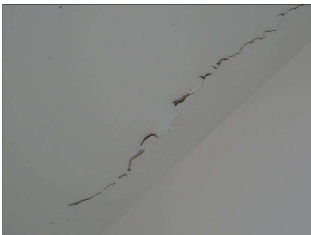
foto /51/ Trhliny u vnitřních konstrukcí na chodbách, degradace výmalby
