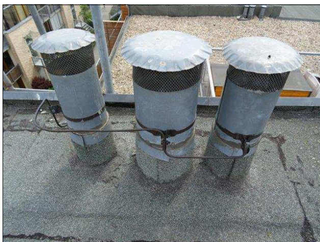
foto /7/ Komínky odvětrání kanalizace – hydroizolace vytažena do výšky cca 150-200 mm a ukončena plechovou objímkou
