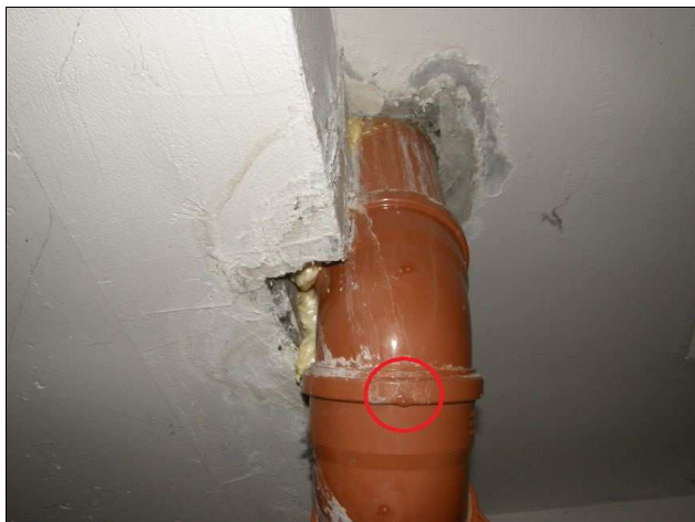
foto /75/ Degradace stavebních konstrukcí v patě stoupačky, tvorba kapek vody
