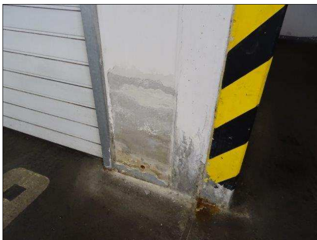
foto /31/ Projevy vlhkostních poruch u paty stěn v 1.PP
