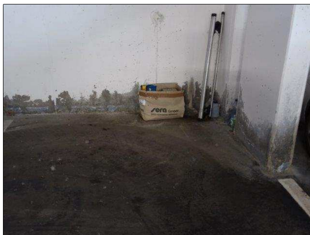
foto /32/ Projevy vlhkostních poruch u paty stěn v 1.PP
