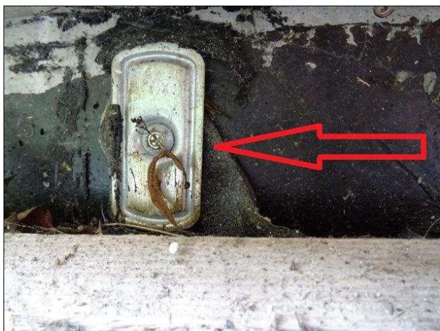
foto /37/ Detail ukončení hydroizolace v místě soklu objektu – utržení asfaltového pásu
