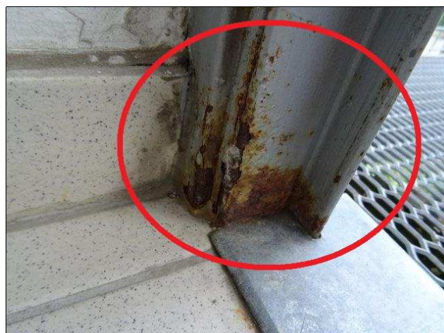
foto /50/ Koroze ocelových zárubní vstupních dveří
