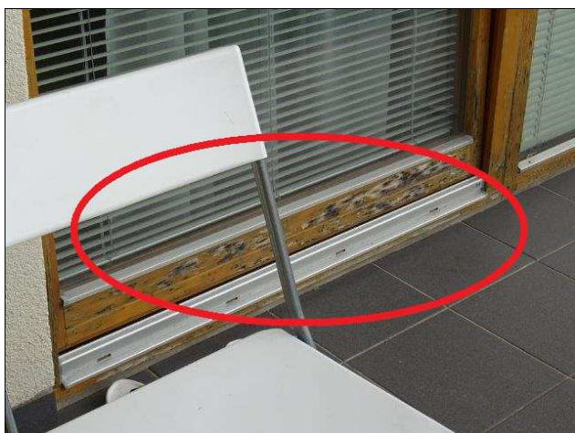
foto /41/ Degradace povrchových úprav dřevěných rámu výplní otvorů
