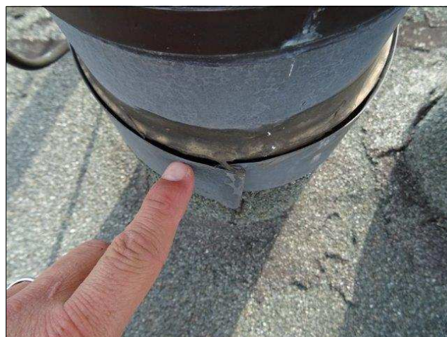
foto /8/ Netěsnosti v místě uvolněné stahovací objímky u vytažení hydroizolace na komínek odvětrání kanalizace - detail
