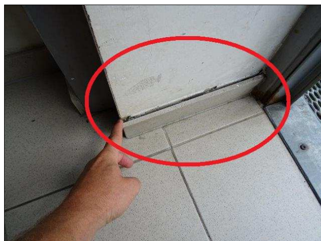
foto /58/ Uvolněný obklad soklu na chodbě
