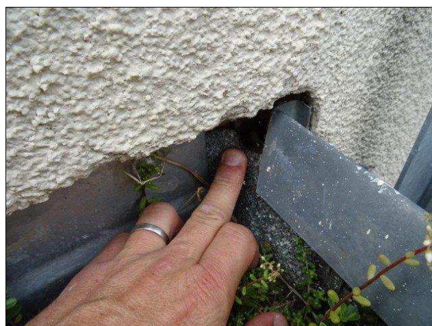
foto /17/ Netěsnost v hydroizolaci na střeše objektu C5 - detail
