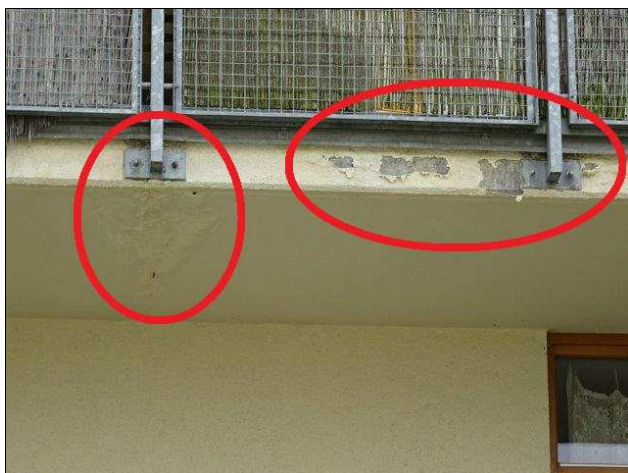
foto /61/ Projevy zatékání balkony – vlhkostní mapy, degradace povrchových úprav
