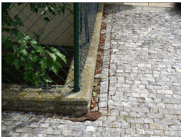
foto /65/ Propadlá dlažba u opěrné stěny ve vnitrobloku objektu
