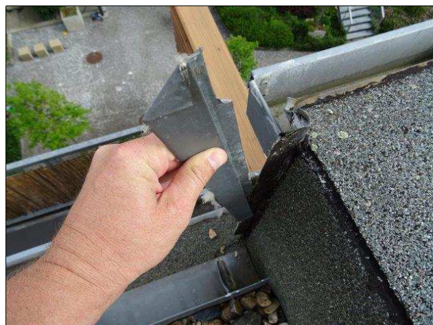
foto /12/ Uvolněná krycí plechová lišta v místě přechodu mezi střechami C2 a C3
