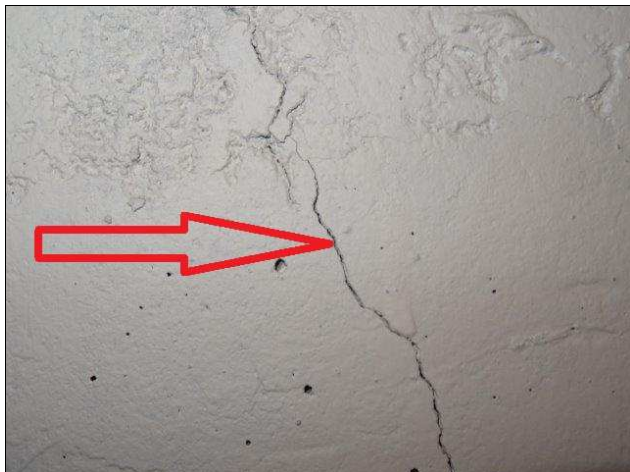
foto /35/ Trhlina u obvodové stěny v 1.PP
