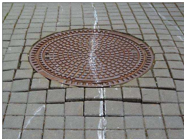
foto /64/ Propadá betonová dlažba na chodníku vnitrobloku - detail
