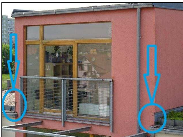
foto /22/ Trhliny v detailu soklu na severní fasádě objektu C6 (4.NP)
