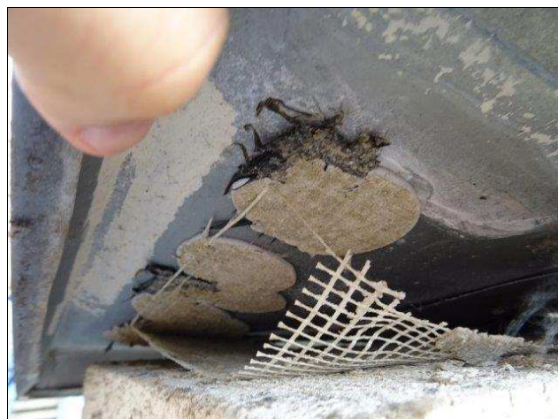
foto /70/ Nedostatečná soudržnost oplechování koruny zábradlí - detail
