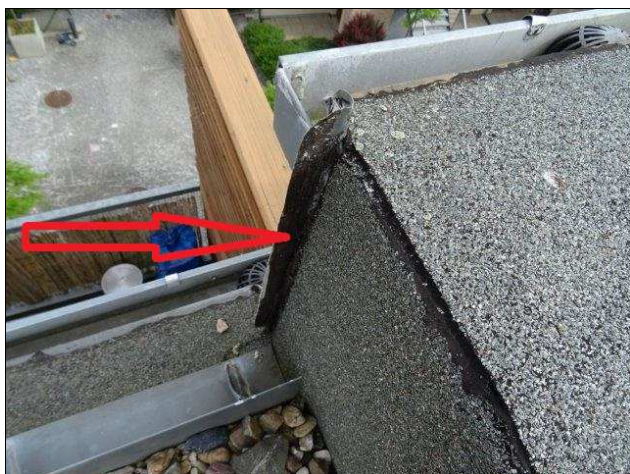
foto /11/ Uvolněná krycí plechová lišta v místě přechodu mezi střechami C2 a C3
