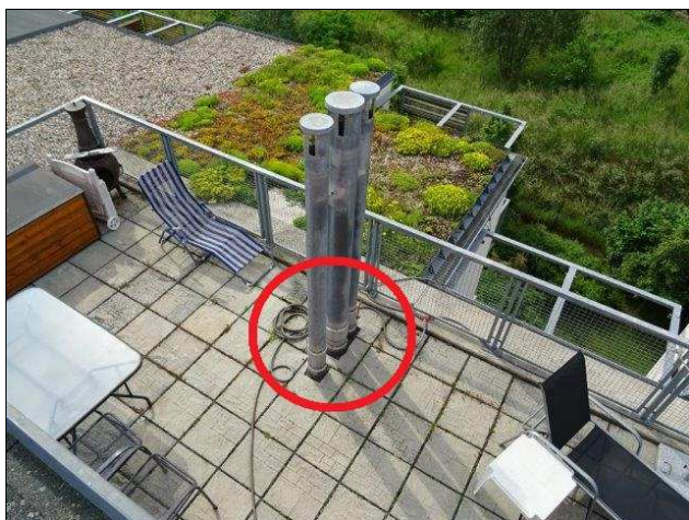
foto /9/ Kruhové prostupy odvětrání kanalizace na střeše objektu C1
