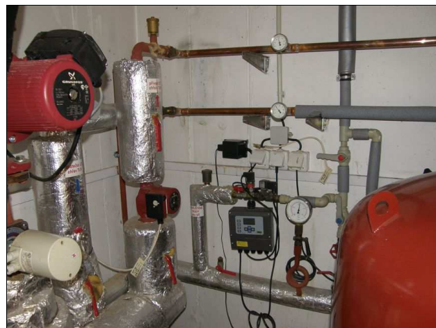
foto /80/ Rozvody a úprava TV
