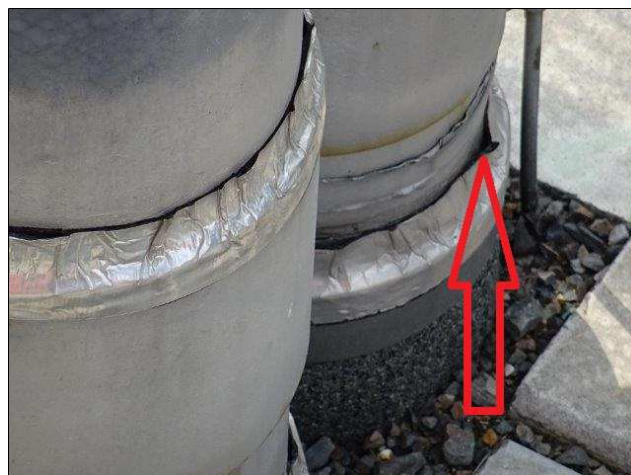
foto /10/ Netěsnosti v místě ukončení hydroizolace na kruhovém prostupu (objekt C1)
