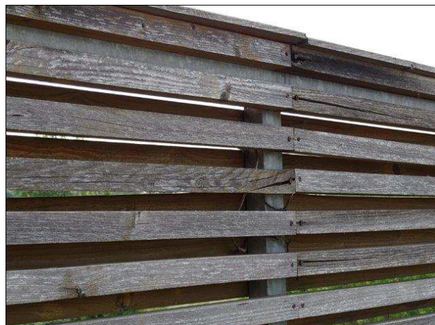
foto /72/ Degradace nátěru dřevěných konstrukcí, lokální praskliny a zkroucení dřevěných prvků
