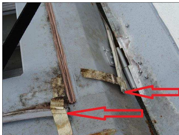
foto /14/ Uvolněné nebo poškozené těsnění u střešního výlezu (objekt C)
