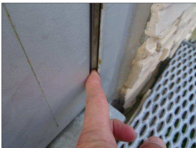
foto /49/ Netěsná funkční spára vstupních dveří
