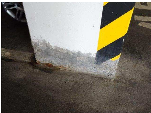
foto /33/ Projevy vlhkostních poruch u paty sloupu v 1.PP
