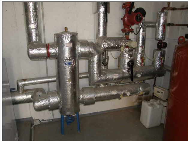
foto /78/ Termohydraulický rozdělovač a rozvody v kotelně
