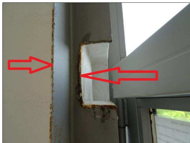
foto /48/ Koroze ocelových prvků u ostění vstupních dveří
