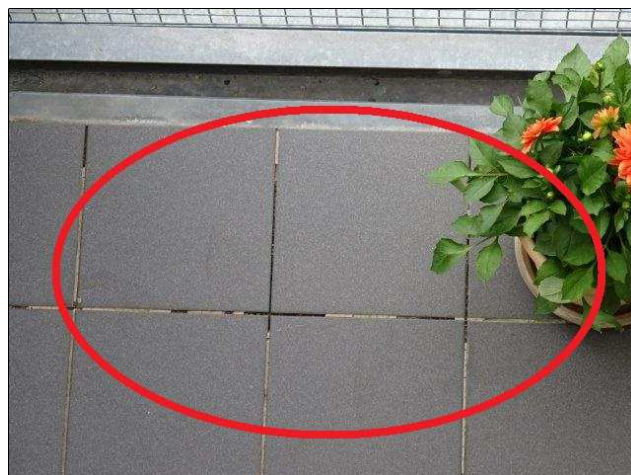
foto /60/ Vydrolená spárovací hmota na balkonech
