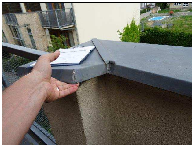
foto /69/ Nedostatečná soudržnost oplechování koruny zábradlí
