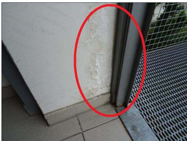
foto /47/ Degradace vnitřního ostění vstupních dveří působením vlhkosti
