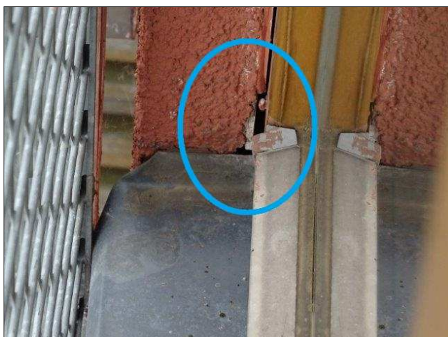
foto /45/ Hydroizolační netěsnosti v místě napojení ostění okna na parapet
