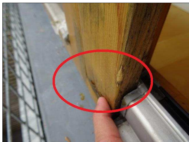
foto /42/ Ztrouchnivělé dřevo na rámu okna
